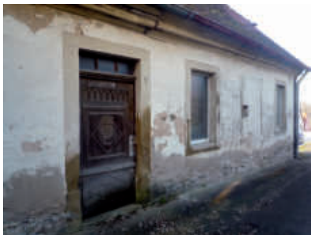
Sanierungsbedarf in Heugrumbach
