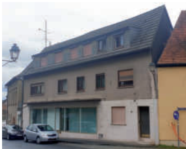
Sanierungsbedarf und Gestaltungsmängel Marktstraße
